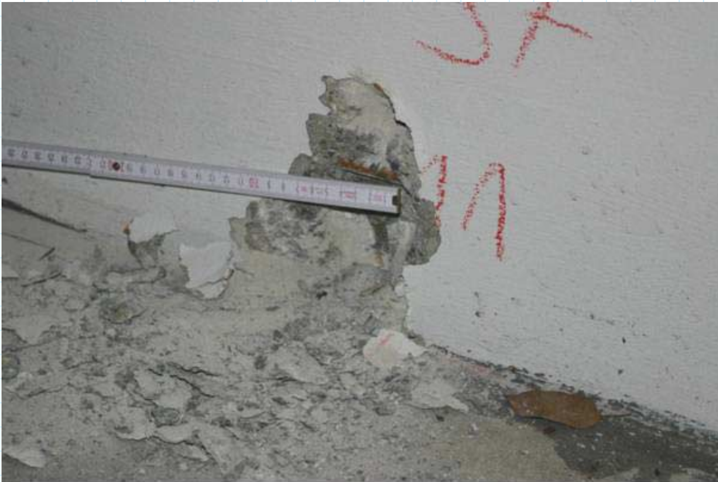
Zu geringe Betondeckung, Baujahr 2002
